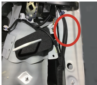
①配線の切断部確認
